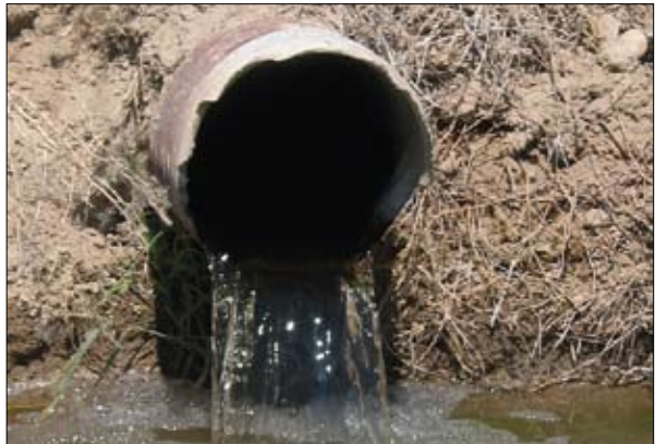
Figura 6. Aguas de escorrentía en un campo de alfalfa donde hay una buena capa de vegetación, la cual atrapa los sedimentos.
